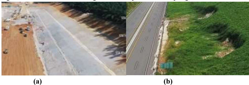
Gambar 8. a dan b Kondisi gerusan pada lereng, terutama kaki, pada saat konstruksi (a) dan operasional (b) yang mengindikasikan terjadinya washing effect
