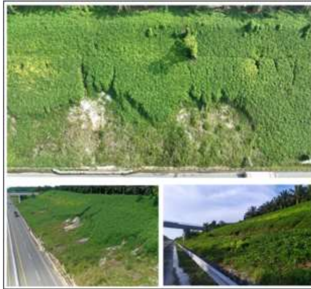
Gambar 3. Kondisi Lereng KM 23+175 - KM 23+325 sebelum ditangani (est. 2021 s.d 2023)
