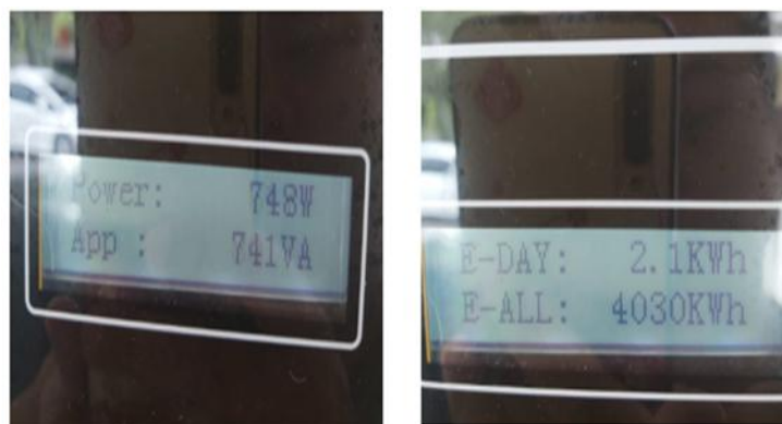
Gambar 4. Tampilan di layar inverter Sumber: Dokumentasi Penelitian, 2023
