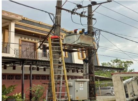
Gambar 3. Trafo Distribusi GT. TBL052.
